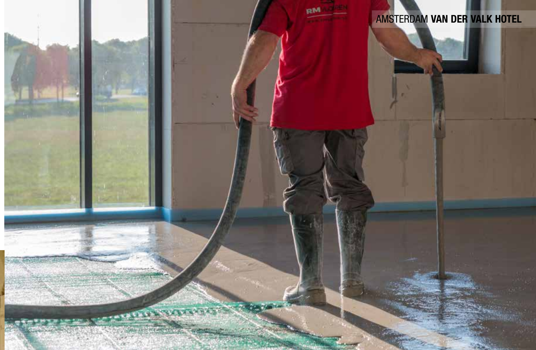
RM Vloeren brengt eco2floor op een Arbovriendelijke manier (staand) in fasen aan.
